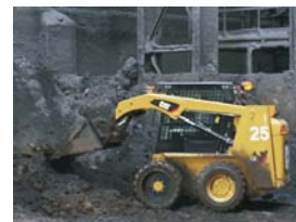
La minicargadora compacta Cat 226B realiza tareas de limpieza en la evacuación de humos.
