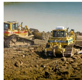
Tractores de cadenas D6 trabajando, como parte de la flota de 40 unidades Cat en la obra.
