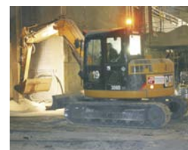
La excavadora Cat 308 realiza pequeños trabajos de limpieza y acondicionamiento de las instalaciones de la acería.
